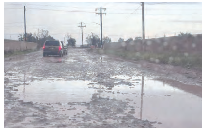
Las calles más afectadas están en ampliación Lázaro Cárdenas y Tres Arbolitos.
